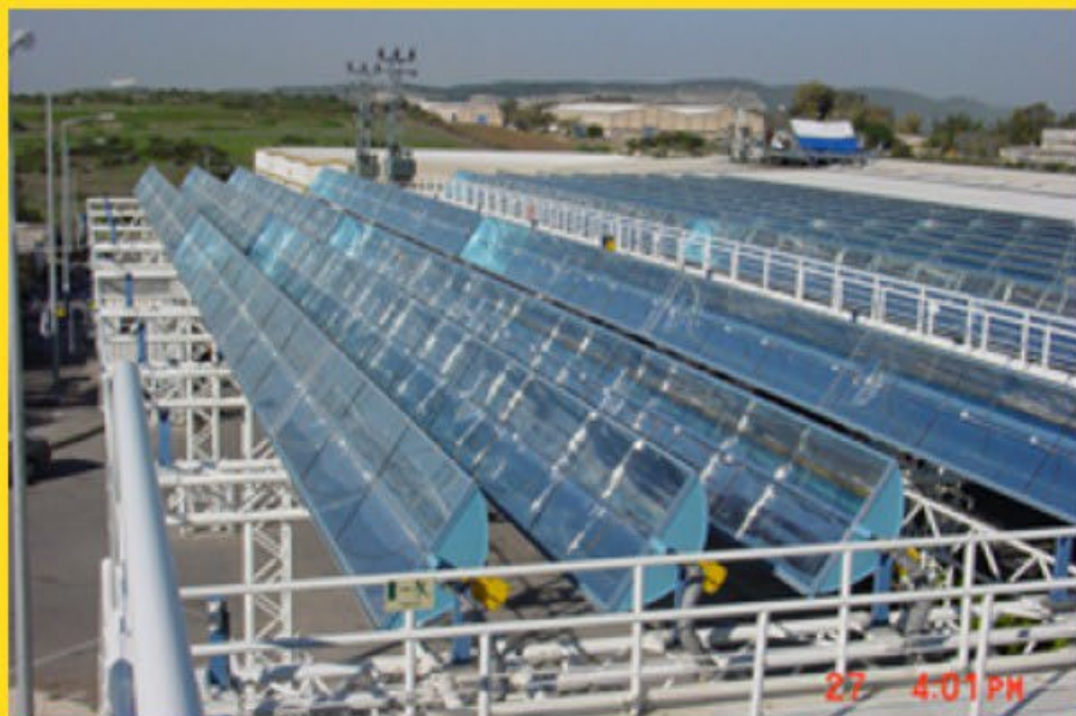
Esempio di impianto a concentratori parabolici. Su questo schema l'ENEA ha sviluppato il progetto Archimede.
